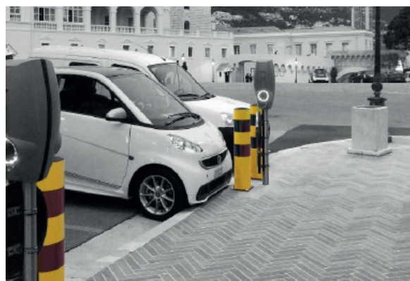
Figure 6 : Exemple de protection d'un point de recharge 19
